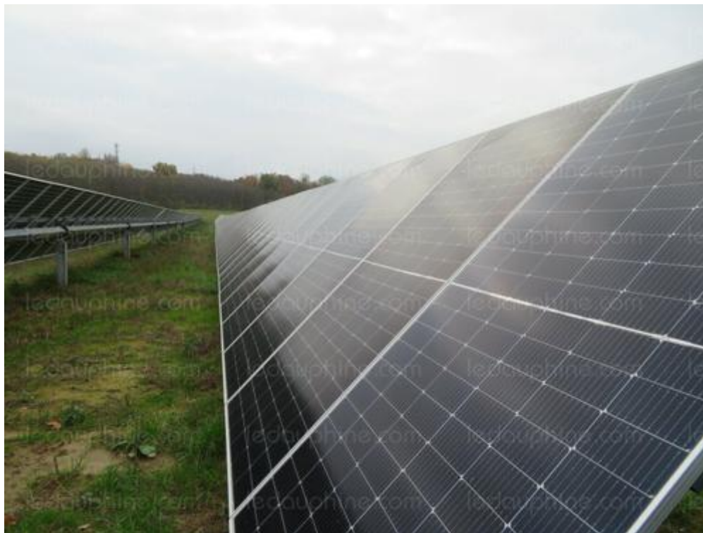
Les 9 050 panneaux photovoltaïques s'étendent sur 6,5 hectares et 45 rangées. Photo Le DL /T.B. Les 9 050 panneaux photovoltaïques s'étendent sur 6,5 hectares et 45 rangées. Photo Le DL /Tim BUISSON
