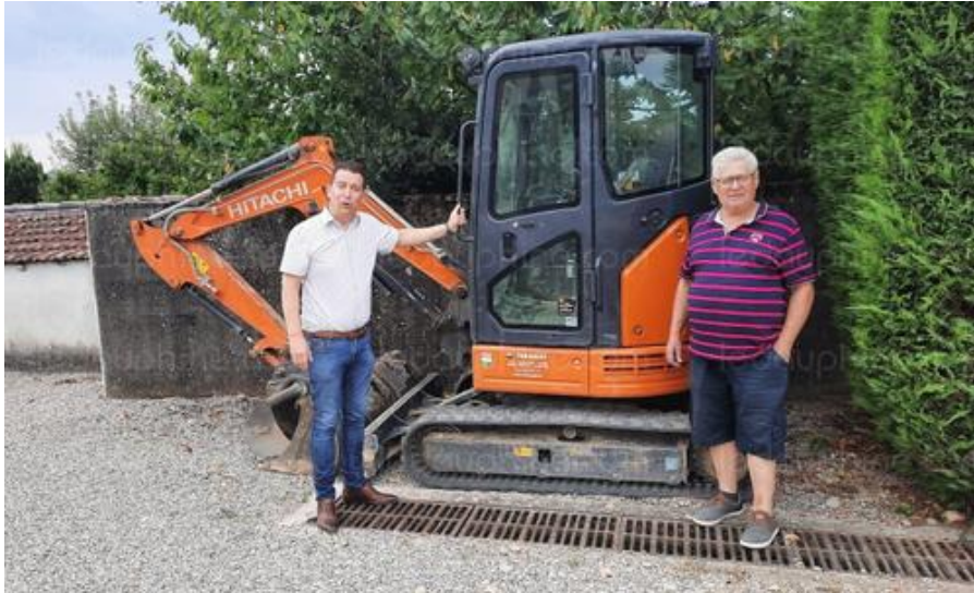
Christophe Charles, maire de Luzinay, et Gérard Locatelli, premier adjoint, en visite sur le chantier du cimetière communal. Photo Le DL /Françoise GRANJON
