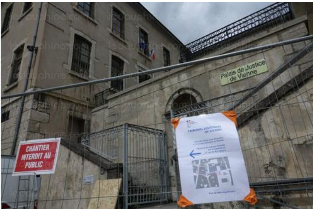
Les travaux de rénovation du tribunal judiciaire de Vienne condamnent l'entrée historique. L'entrée s'effectue désormais depuis la rue de Bourgogne. Photo Le DL / Vincent WALES
