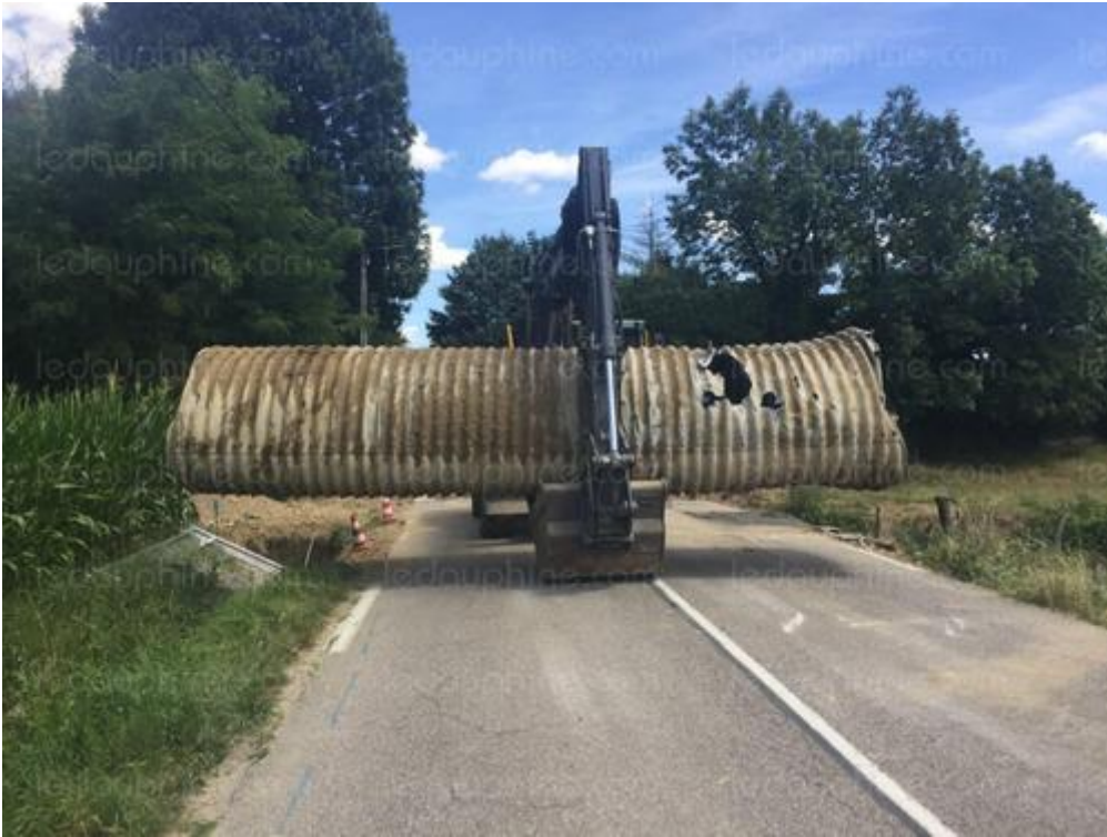
Les travaux de reconstruction du pont du Canis réalisé par le département de l'Isère s'étaleront jusqu'au 7 août. Photo Le DL /Francoise GRANJON
